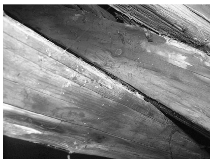
Figura 2.4.b. – Șarpanta imobilului str. Kogălniceanu nr. 6 – poziția căpriorului față de elementul longitudinal orizontal al sistemului de rigidizare
