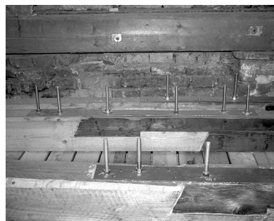
Figura 5.5.c. – Același detaliu de continuizarea executat corect, la nivel de calitate ridicat cu respectarea proiectului;
