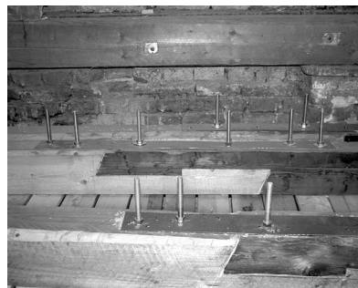
5.5.c. ábra – Ugyanaz a csomópont, helyesen, magas szakmai szinten kivitelezve, a terv betartásával.
