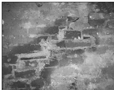
Fig. 5.5.a. — Rejointoiement de voûte réalisé par des contremaîtres spécialisés employés par l'entrepreneur général — Tileagd, Ecole primaire et collège
