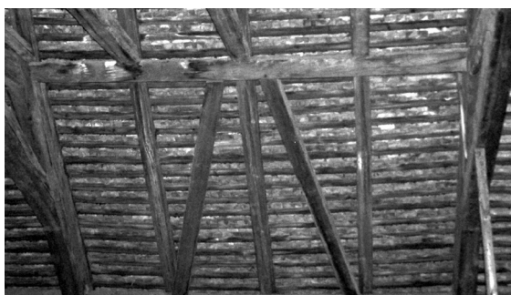
Figura 2.4.a. – Șarpanta imobilului str. Kogălniceanu nr. 6 – sistem longitudinal de rigidizare "clasică", forma \Lambda
